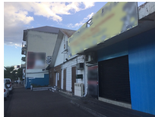
Mauvais état d'entretien des dispositifs peu qualitatifs, rue Saint-Louis
